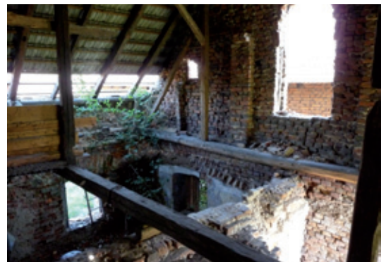
Wnętrze częściowo zniszczonego budynku z Międzyrzecza (wyburzonego w 2019 roku).
